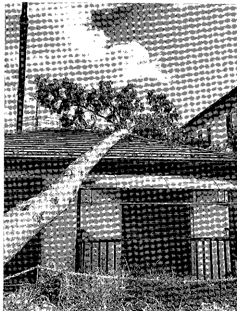
左上：幹元から折損し家屋の屋根に倒れたアカマツ。その枝は屋根を貫通し天井まで突き刺さっていた
